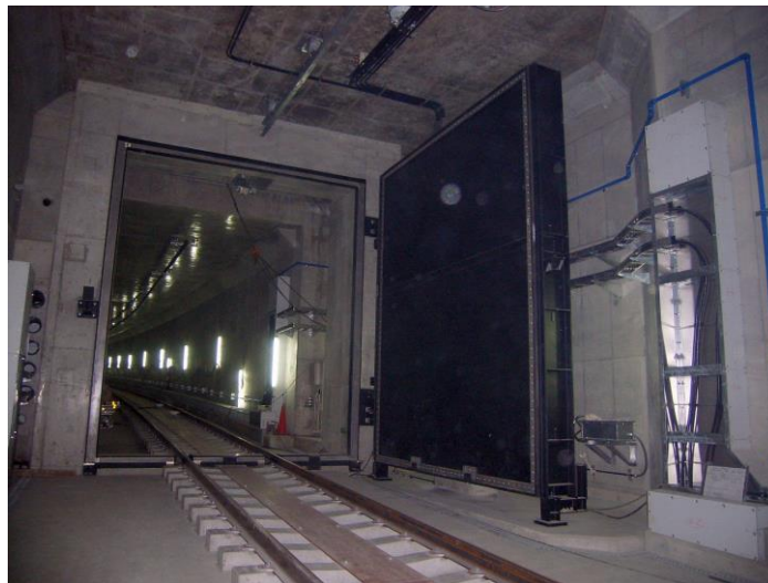
止水鉄扉設置状況（天満橋駅西側）
